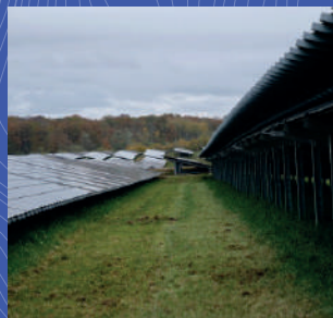
Panneaux photovoltaïques : La Chapelle Réanville
